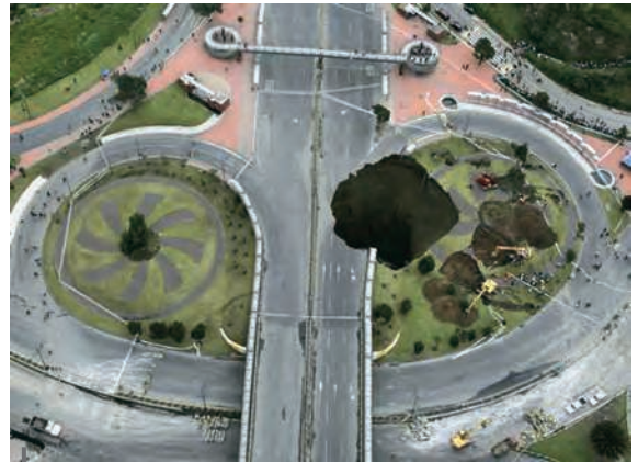
Figura 2 – Vista aérea del hundimiento «El Trébol»
