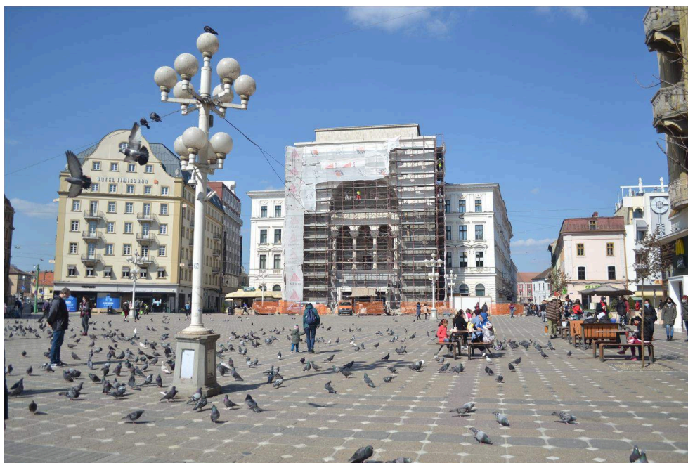
Illustration 13 - Façade de l'Opéra national de Timișoara en cours de restauration sur la place de la Victoire
