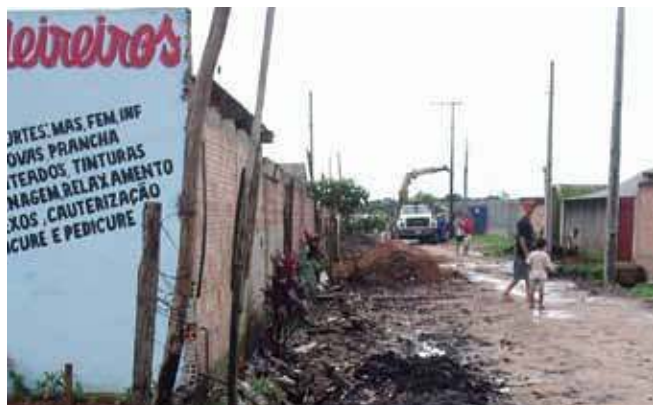
Ligações irregulares de água, improvisadas pelos moradores.
