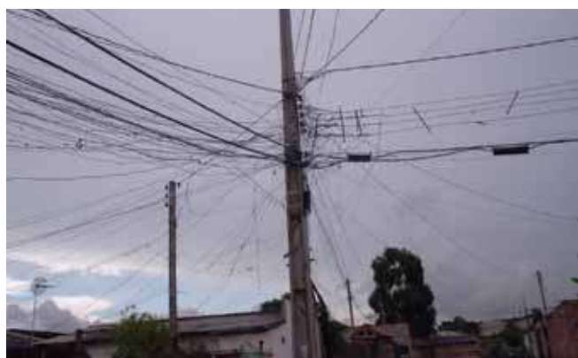
Ligações irregulares de energia elétrica, improvisadas pelos moradores.
