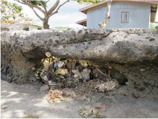
PHOTO 4. – Digue endommagée à Malawai, île de Gau, Fidji, 04/06/2016 (© Élodie Fache)
