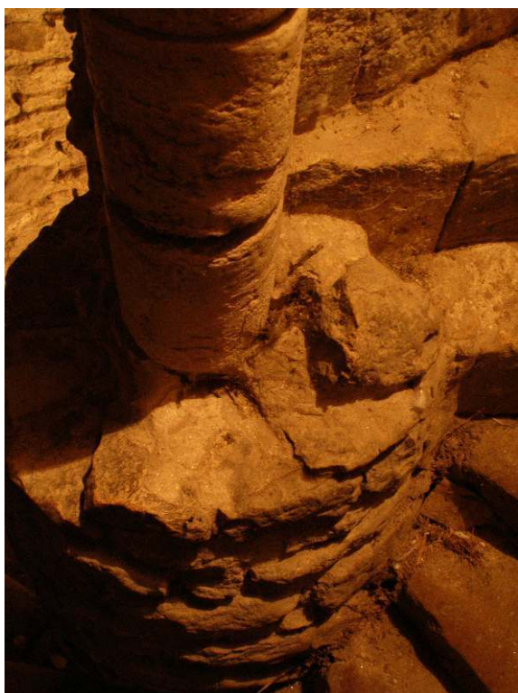
Amincissement du noyau de l'escalier en vis menant au clocher Cl. É. Baillieul.
